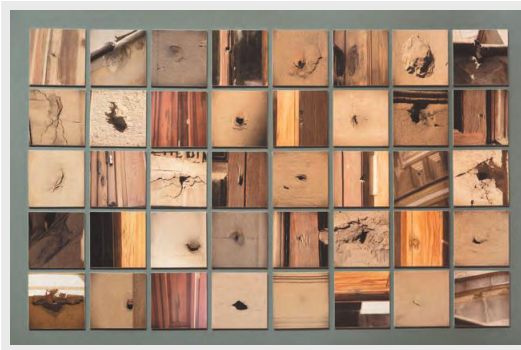
Impactos de bala en la fachada del MNBA registrados por Macarena Álvarez el 17 de octubre del 2014. Foto: Jorge Brantmeyer
